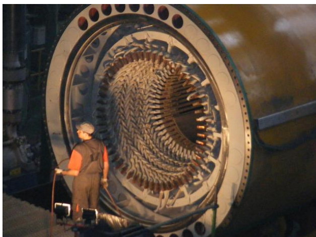
Rys. 1 . Generator z częściowo zdemontowanym uzwojeniem.
