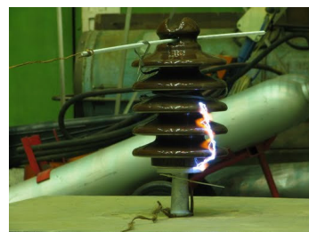
Rys. 2 Przeskoki na izolatorach
